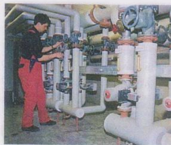
Met behulp van een datalogger, wordt de installatie gemeten.
