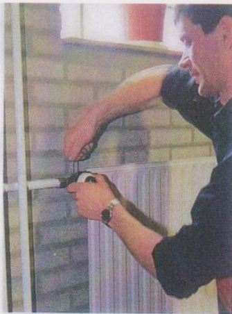
Een van de onderdelen van het waterzijdig inregelen is het inregelen van de radiator.
